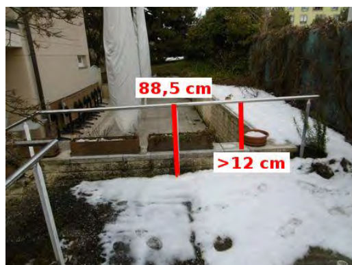
Balustrade extérieure non conforme
