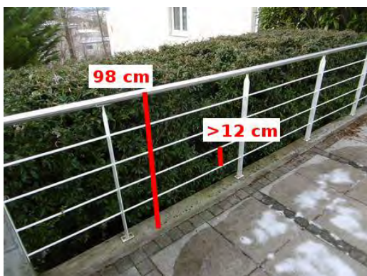
Balustrade terrasse : élément non conforme en soi mais haie rendant la situation conforme
