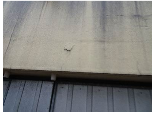
Infiltration d'eau dans le local vélo par une obturation grossière en mortier
